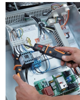
测量压缩机电压
