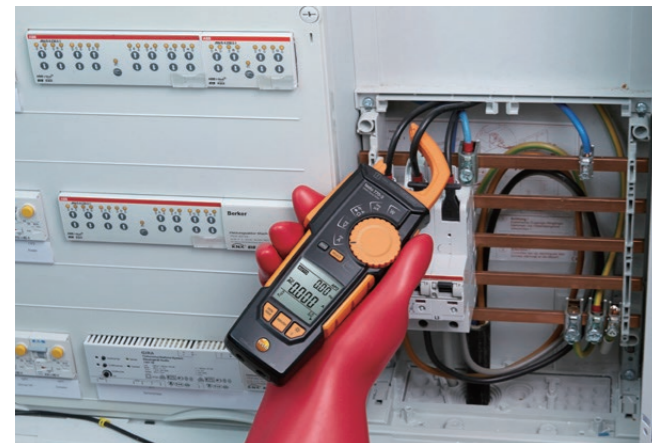
测量开关柜电流
