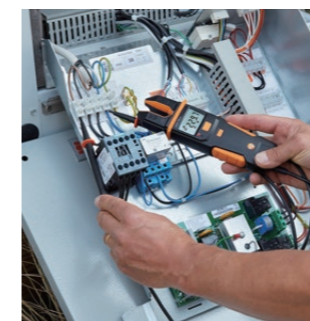
测量压缩机电压
