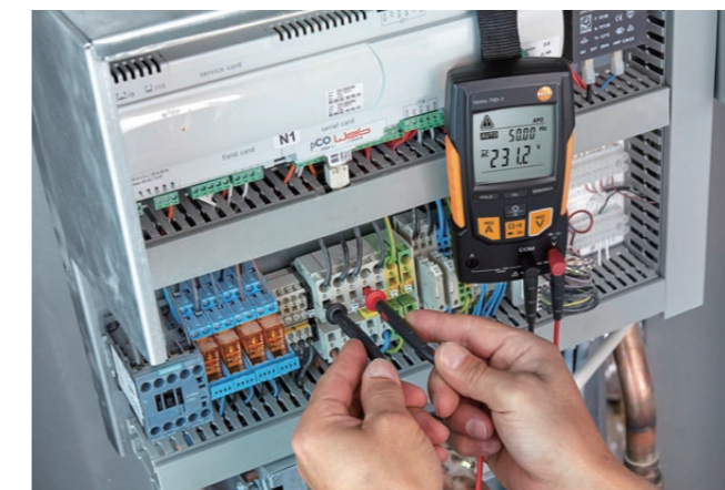
测量热泵开关盒中的电压
