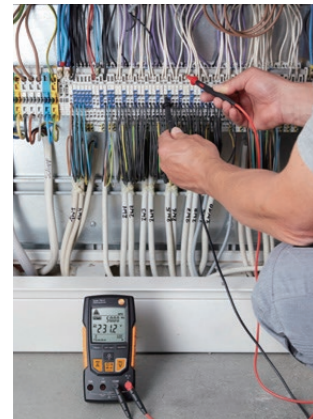
测量开关柜中的电压
