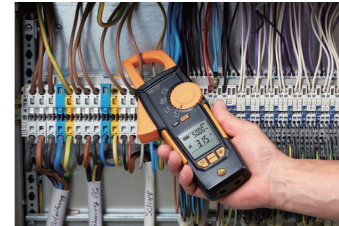
测量开关柜电流
