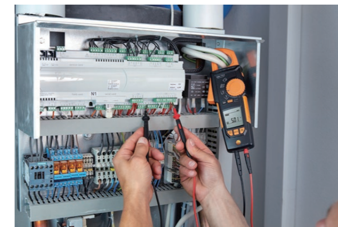
测量开关柜电压
